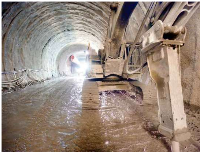
Podľa odborníka mohla byť jednou z príčin problémov aj zvolená talianska metóda razenia. ILLUSTRÁCIA FOTO: HN/FAVOL/FINTEAL
